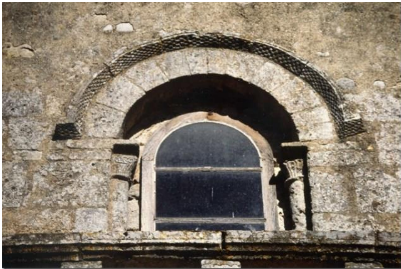
Baie occidentale de la façade de l'église de Saint-Georges-sur-Arnon (Indre ; 36) dont il manque le tore, le boudin supporté par les colonnes à chapiteau
